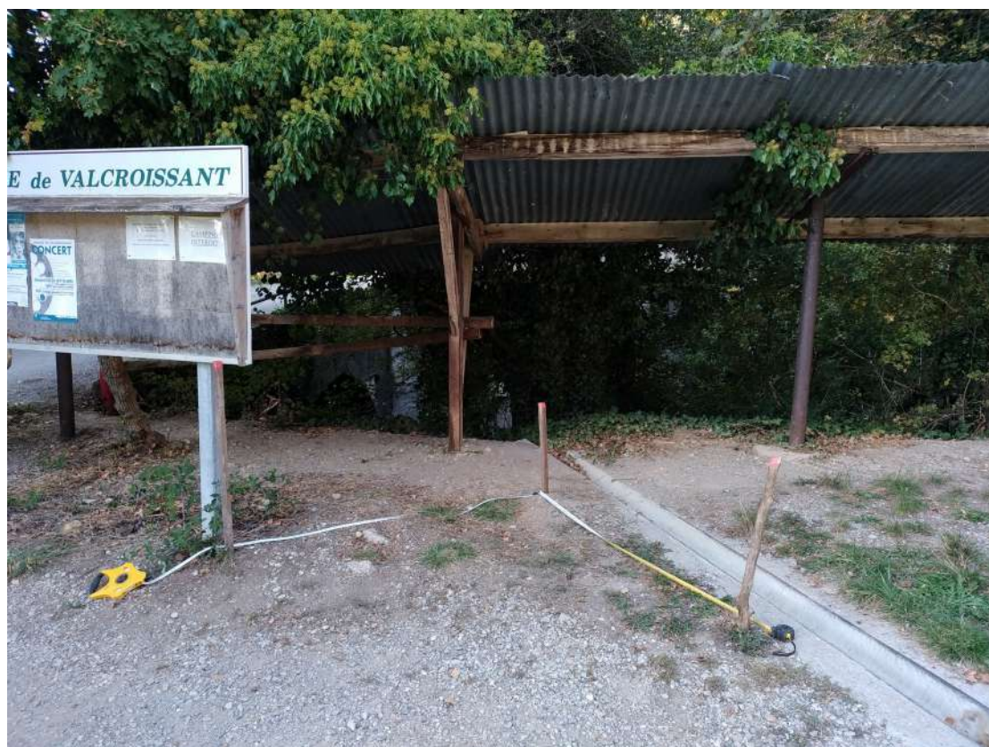
Porte du haut. (passage de véhicule validé, on a essayé de limiter de décaissement, M.Légaut demande a être vigilant sur la fortification du talus après les travaux)
