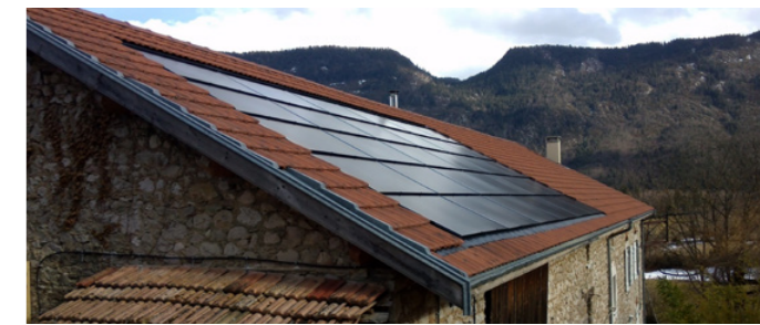
Toit Centrales villageoises de VercorSoleil
